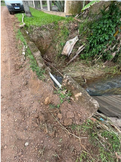
Arroio do Mengue, Ponte comprometida.
