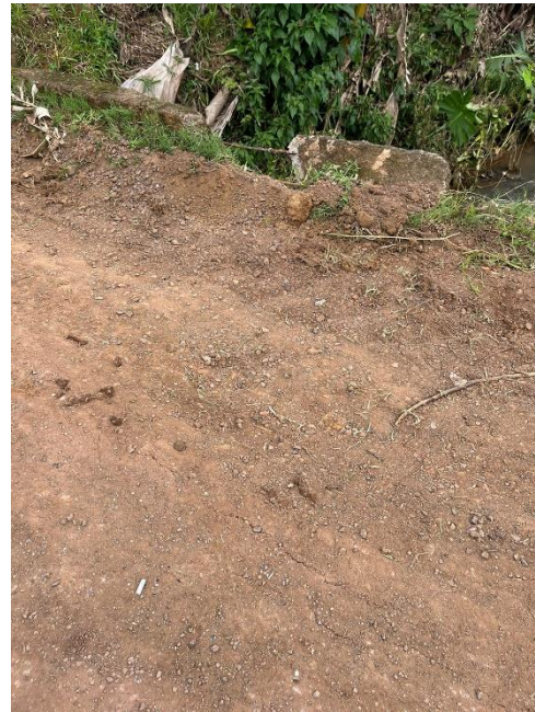
Arroio do Mengue, Ponte comprometida e base cedida.
