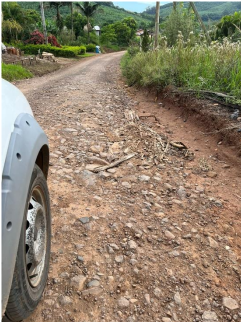
Estragos na estrada dos Morro dos Leffas.
