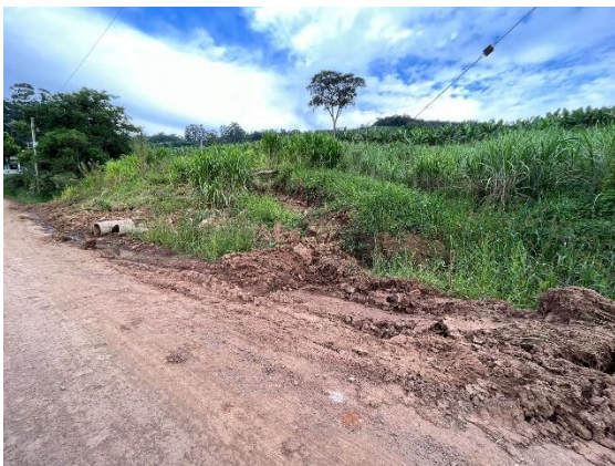
Morro dos Leffas, deslizamento.
