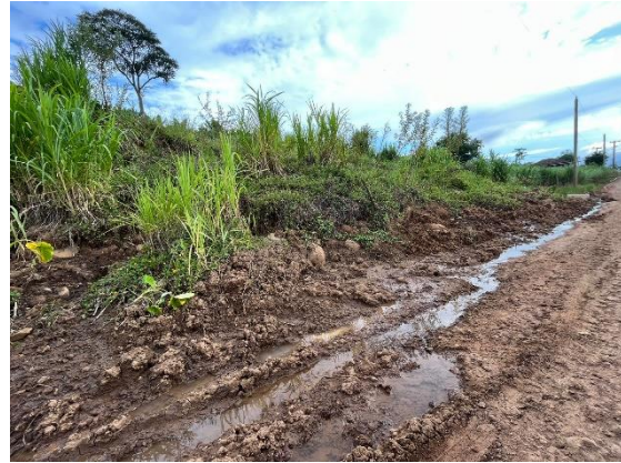
Morro dos Leffas, deslizamento.
