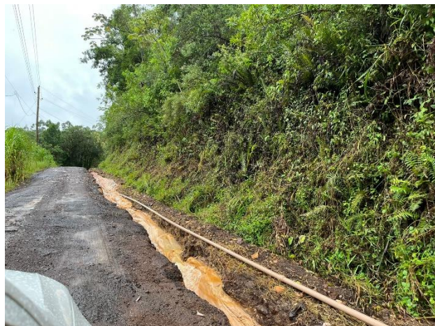
Arroio dos Mengue, canalização de Água potável.
