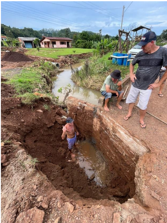
Arroio do Mengue, Ponte comprometida.
