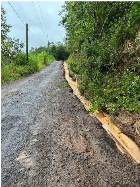
Arroio dos Mengue, canalização de Água potável.
