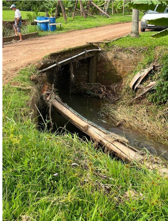
Arroio do Mengue, Entupimento de bueiro.
