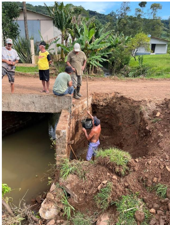
Arroio do Mengue, Ponte comprometida.
